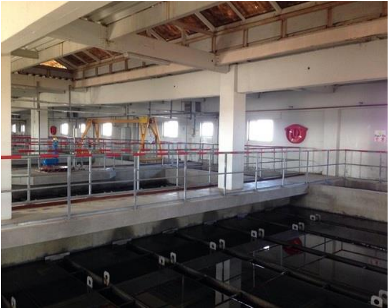
Figura 85 Stația de captare și tratare Crivina Sursa www.news.ro
